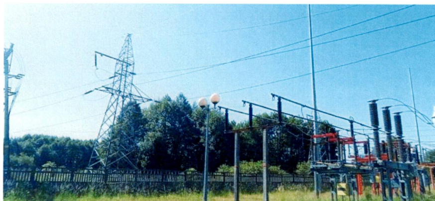
Rozdzielnia napowietrzna 110 kV – wyjście linii 110 kV Płaskowice
