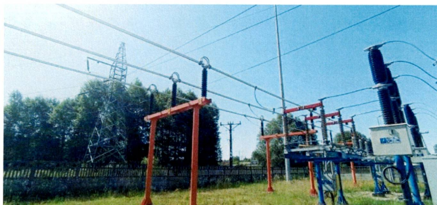
Rozdzielnia napowietrzna 110 kV – wyjście linii 110 kV Szreniawa
