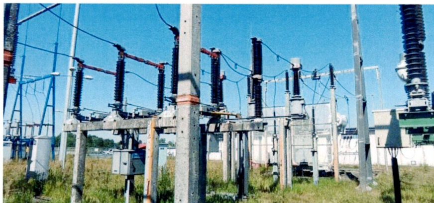
Rozdzielnia napowietrzna 110 kV – pole rozdzielcze transformatora nr 1
