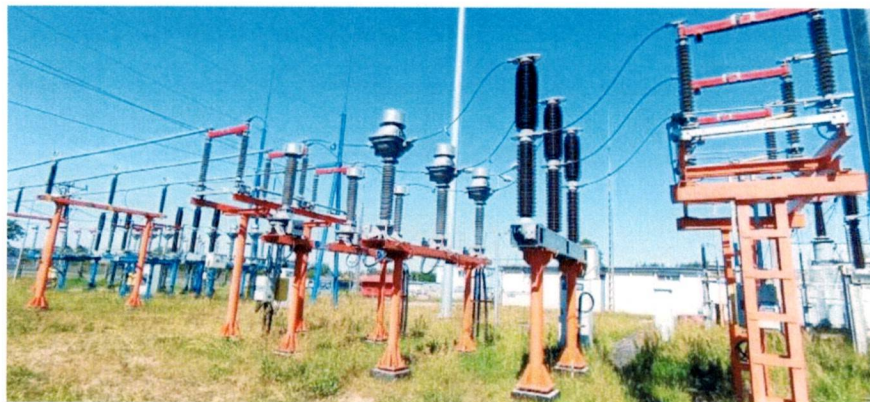
Rozdzielnia napowietrzna 110 kV – pole rozdzielcze sprzęgła
