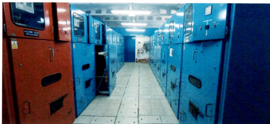
Rozdzielnia w ę trzowa 15 kV
