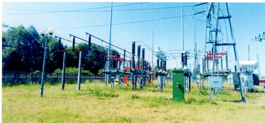
Rozdzielnia napowietrzna 110 kV – pole rozdzielcze linii Płaskowice
