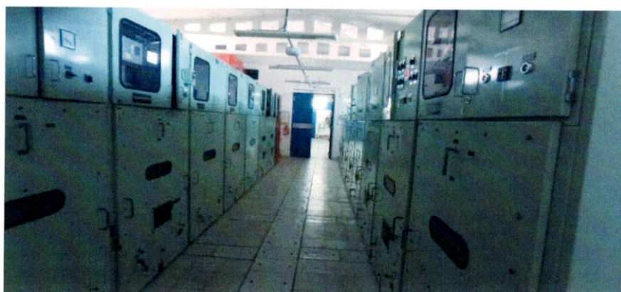
Rozdzielnia wewn ę trzna 15 kV
