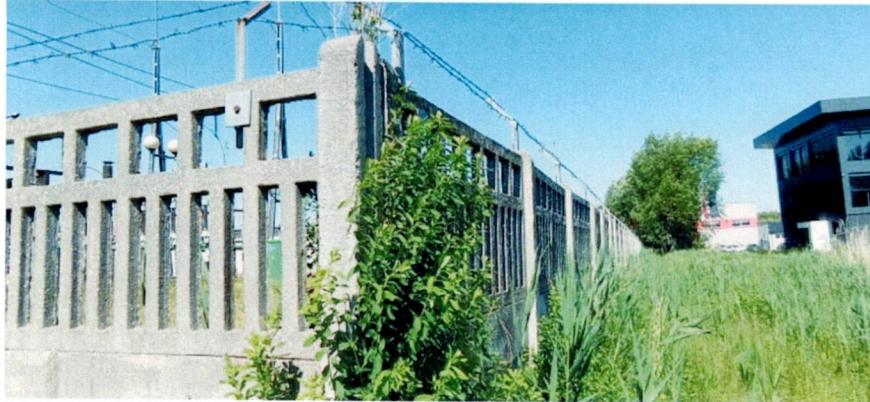
Otoczenie stacji 110/15 kV Przedbórz
